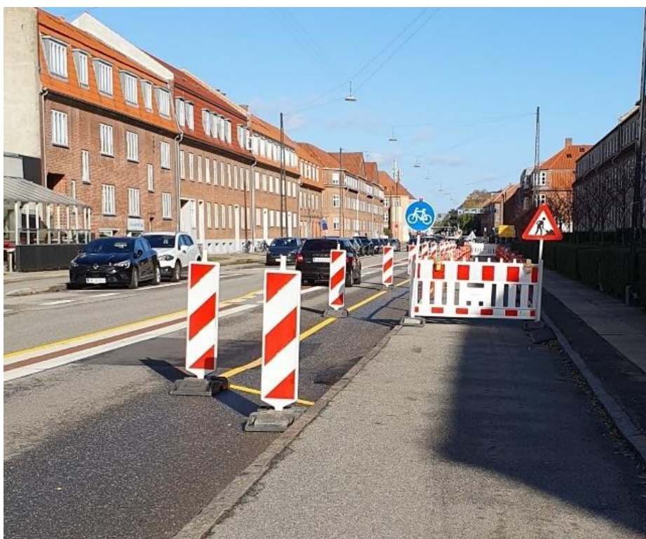
Foto 14. Illustration til spg. 58, 59, 60 og 61. Vejarbejdsopstilling 3. Cykelsti spærret. Cyklister henvises til vejbanen, adskilt fra bilerne med en gul delelinje og N 42 tavler.
