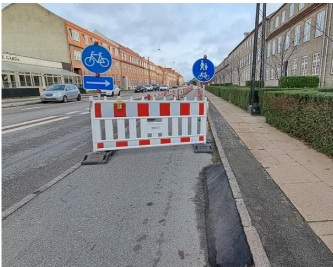
Foto 12. Illustration til spg. 48, 49, 50, 51 og 52. Vejarbejdsopstilling 1. Cykelsti spærret. Cyklister henvises til fællessti på fortov.
