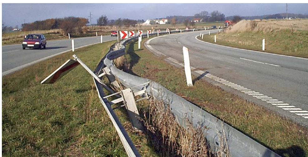
Enkelt-sided stålautoværn med IPE profil. Foto: Vejdirektoratet.
