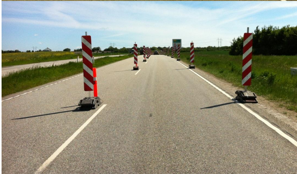
Etape 2 – N42 korridor, afstand mellem N42 tavler, t = 15 m. Foto i køreretning mod øst.
