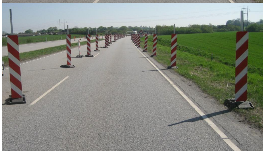
Etape 1 – N42 korridor, afstand mellem N42 tavler, t = 7,5 m. Foto i køreretningen (mod øst).
