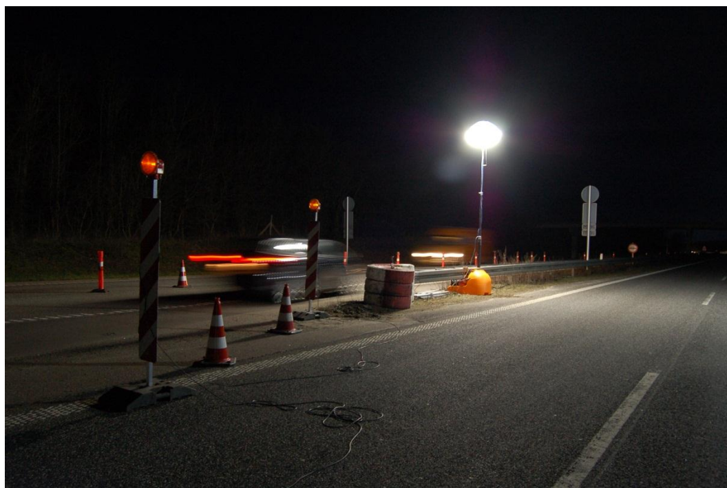
Testopstilling med 2 powermoons. Foto taget ved overledningen i køreretningen. I testopstillingen med 1 powermoon er denne placeret tilsvarende sted.
