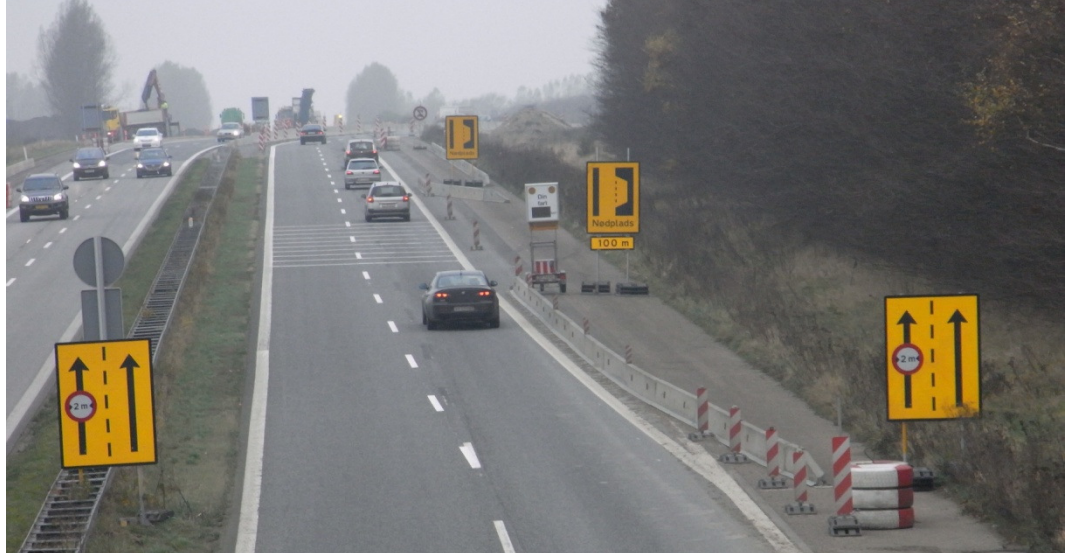
Figur 3: Overledningen til interimsmotorvejen ved Slagelse i retning mod vest. Rumlestriber og "Din fart"-tavle før overledningen.
