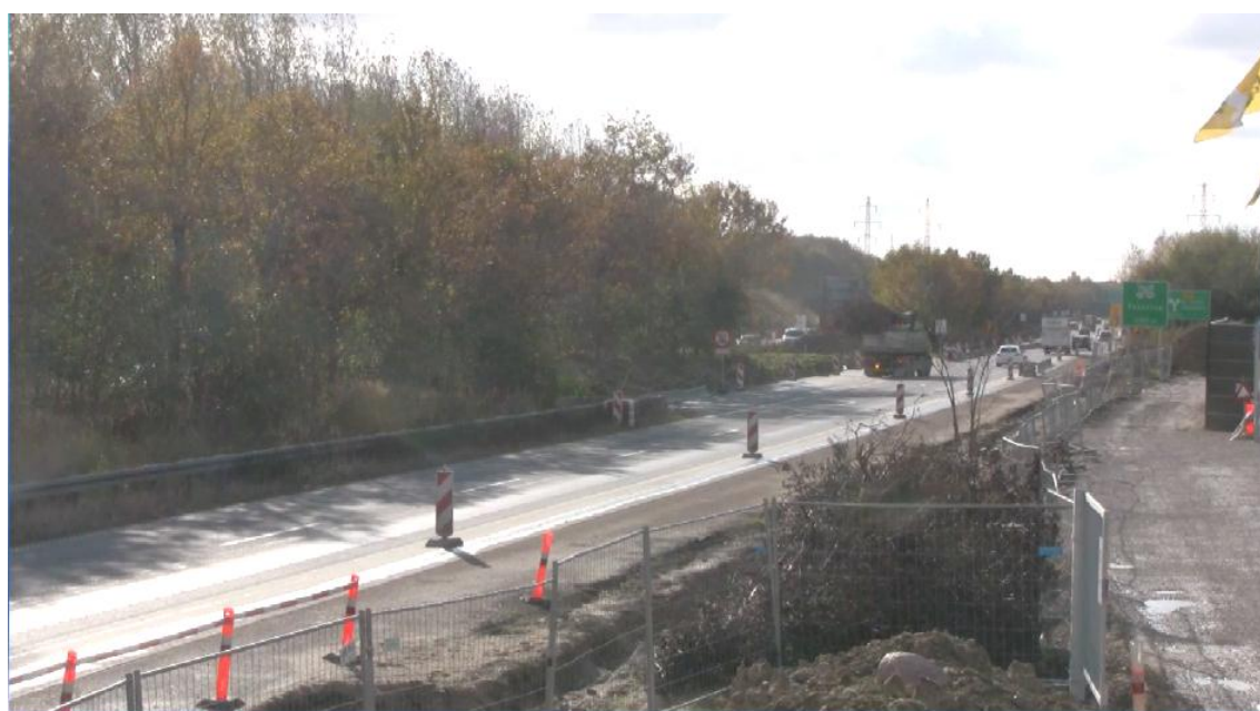
Foto 12. Udkørsel nr. 5. Lastbil blinker til venstre, accelererer op og kører ud på motorvejen. Hastighed er nedskiltet til 50 km/t. VMS på 50 km/t i én hel time i træk.
