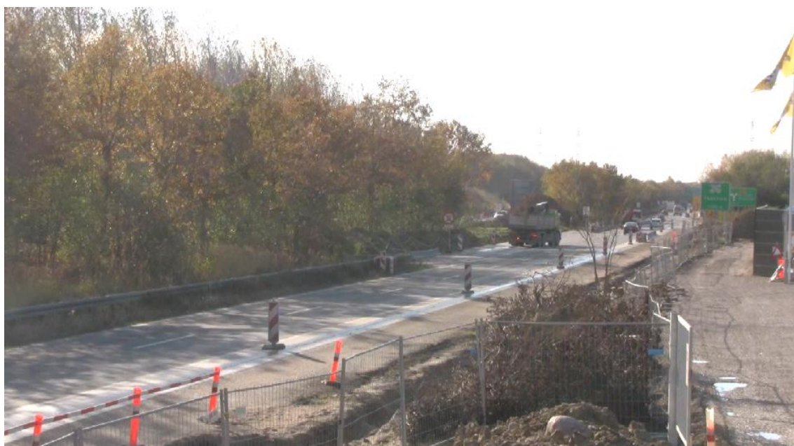
Foto 10. Udkørsel nr. 4. Lastbil blinker og trækker ud, uden at være til gene for andre trafikanter på motorvejen. Hastigheden er nedskiltet til 50 km/t.
