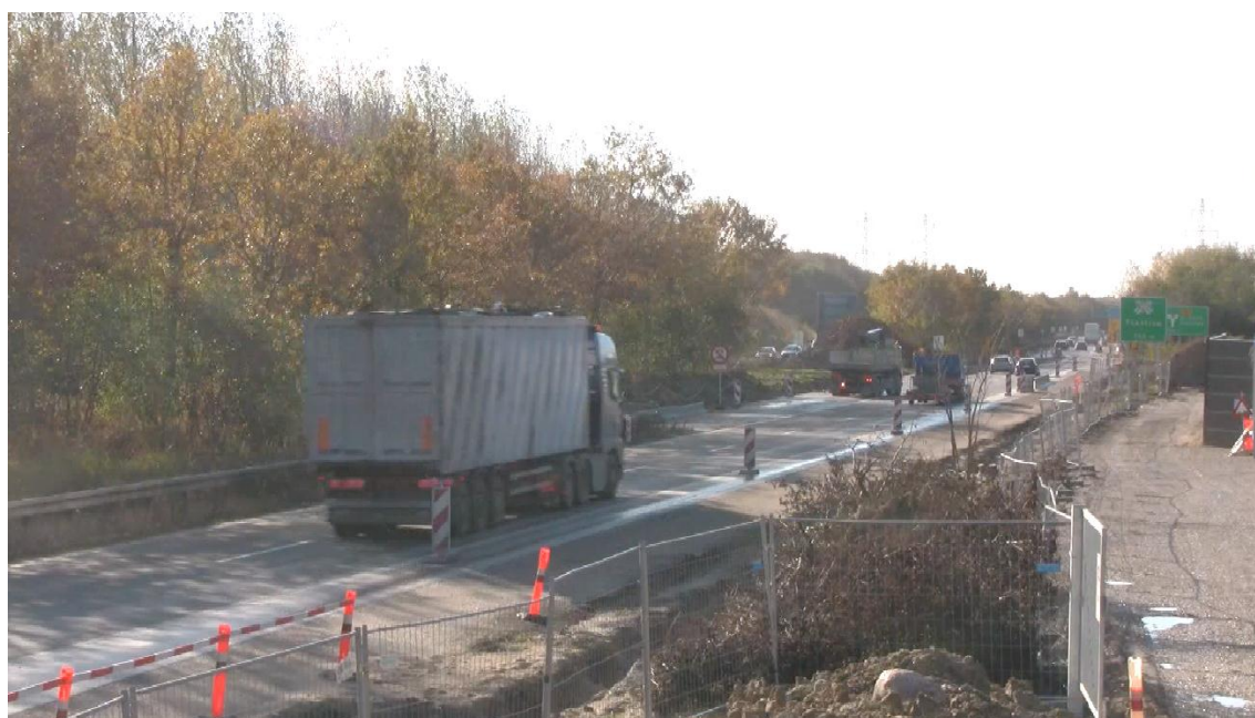
Foto 8. Udkørsel nr. 3. Uproblematisk udkørsel. Hastigheden er nedskiltet fra 80 til 50 km/t.
