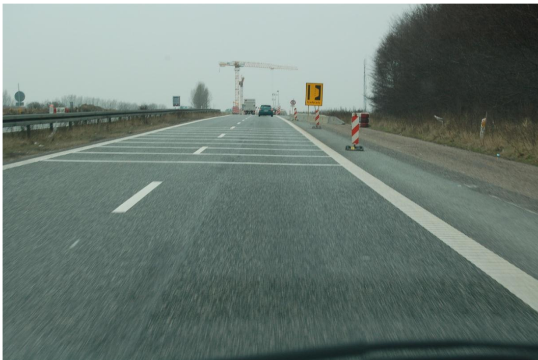
Foto 4. Umiddelbart før rumlestriberne.
