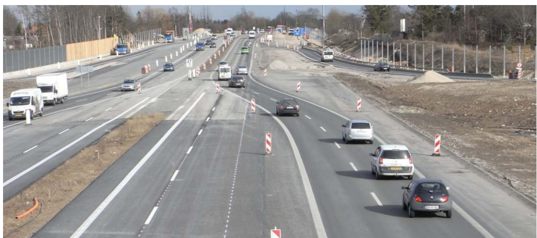
Foto. Forsætning af kørespor i basis-situationen. Set mod øst. Ny opstribning med smalle venstre kørespor er påbegyndt.
