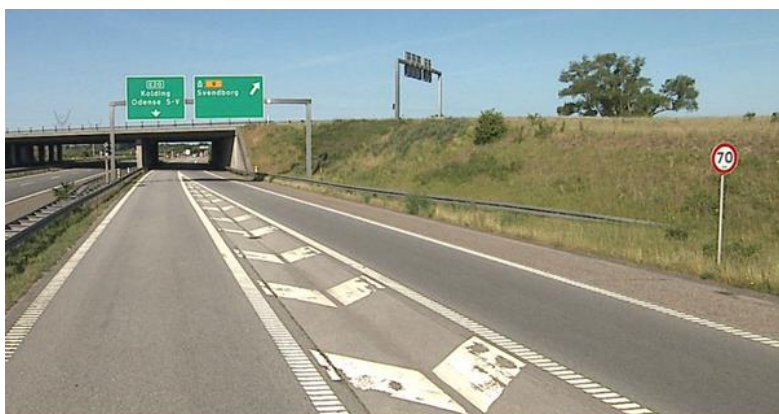
Figur 2.4: Grøn portaltavle i motorvejskrydset mellem den fynske motorvej og Svendborgmotorvejen. Versalhøjden er 340 mm.
