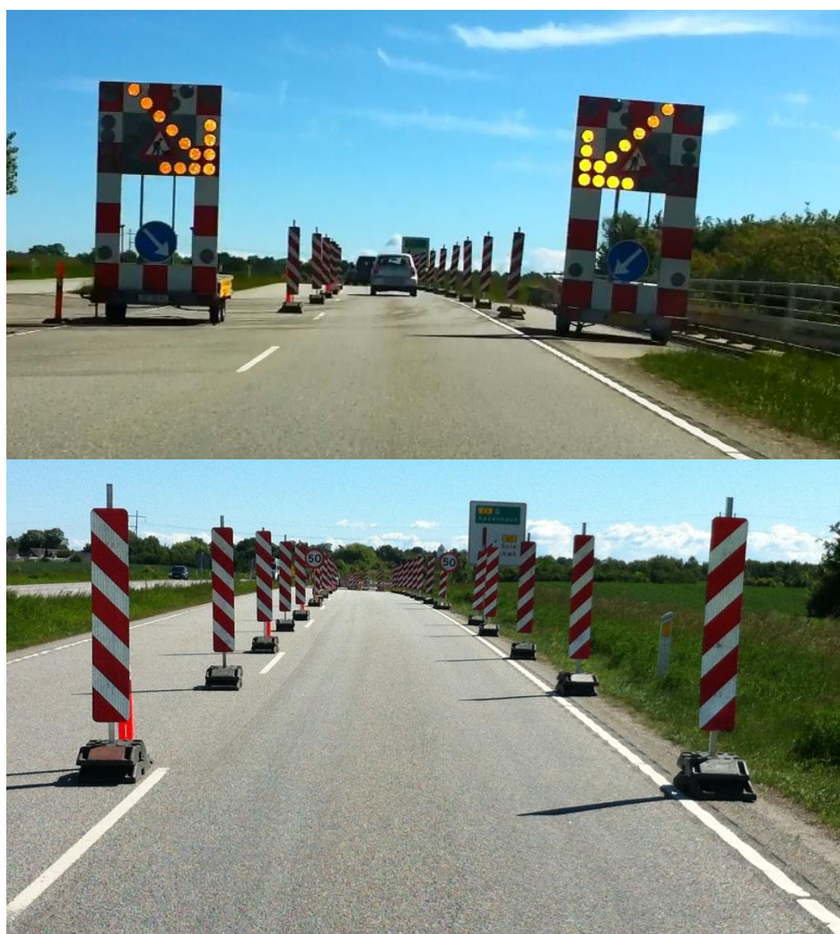
Figur 2.2: Korridorstrækningen på etape 2. Indgangen til korridoren er her markeret med to tavlevogne placeret med 4,5 meters afstand. Nederst ses den 3,65 meter brede korridor midt på korridorstrækningen etableret med de 2 meter høje N42 tavler.
