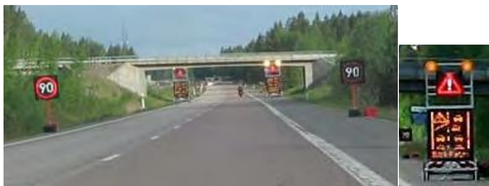
Figur 19.2: Opstilling VMS: De faste tavler blev erstattet med VMS tavler
