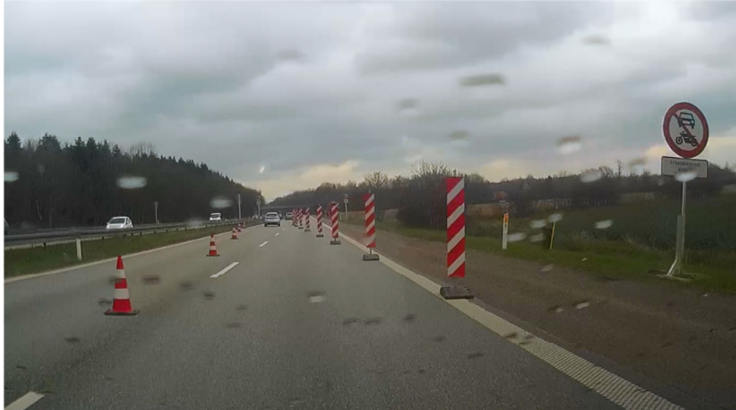
Figur 10: På MF016C er der ikke installeret løbelys på N42 begrænsningslinjen ved forsætningen fra højre til venstre spor.
