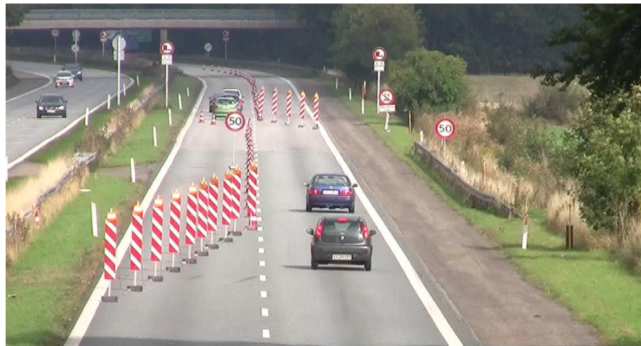
Figur 34: MF016B og MF017B er identiske fra indsnævringen til højre spor og gennem resten af testopstillingen. Her er det MF017B.
