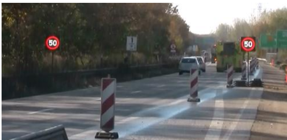
Figur 10.1: VMS-tavlerne aktiveres ved arbejdskørsel ud fra midterrabat for at få en midlertidig hastighedsbegrænsning på 50 km/t.
