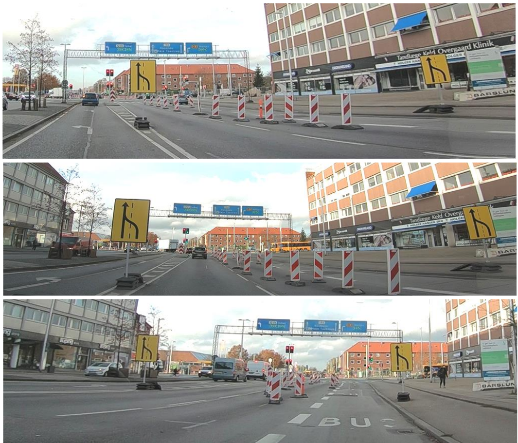
Figur 44. Ringvejskrydset – øverst set fra venstresvingsbane, midt set fra ligeudbane, nederst set fra bus-/højresvingsbane. Man kan forestille sig flere måder, at de midlertidige E16.3.1 tavler har været tiltænkt, men ingen af dem giver mening.
