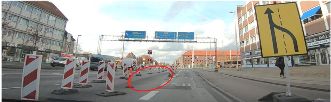
Figur 46. Ringvejskrydset set fra bus-/højresvingsbane. Man kan forestille sig flere måder, at de midlertidige E16.3.1 tavler har været tiltænkt.
