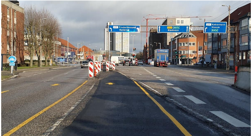
Figur 17. Vejarbejde i byområde. Den gule midlertidige afmærkning er vildledende og fører trafikanterne direkte ind i afmærkningsmateriel. Dette kan - ikke blot for uerfarne førere - give anledning til tvivl om, hvor på vejbanen de skal placere sig - og i værste tilfælde kan det føre til ulykke (foto: Trafitec).
