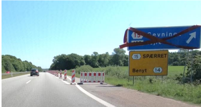
Figur 3.4: Rampen er fysisk afspærret med N42 tavler
